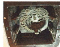
7年放置していた換気システムのファン
