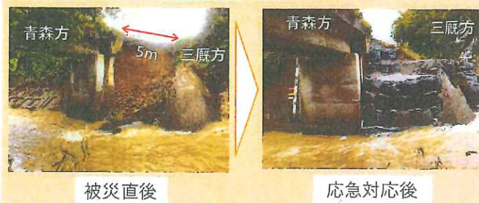
② 第一今別川橋りょう 盛土流出
