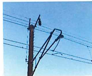
架線金具等の損傷
