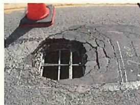
【道路が損傷した例】
